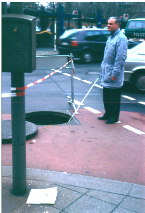
Abb. 10: Die Absicherung dieses ca. 4 m tiefen Schachts nur mit einer „Flutterleine“ muss als grobe Fahrlässigkeit bezeichnet werden.
